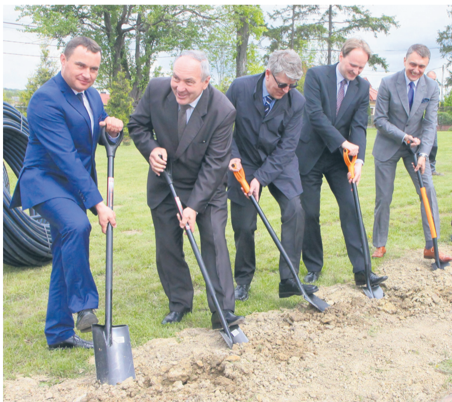
Symbolicznym wbiciem pierwszych łopat rozpoczęto roboty budowlane w ramach projektu „Sieć Szerokopasmowa Polski Wschodniej – województwo świętokrzyskie”
