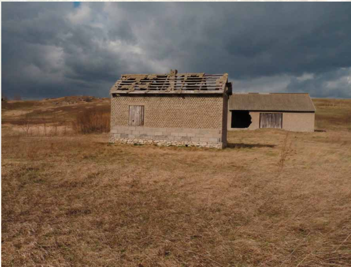
Monika Wrzosekiewicz - Opuszczona stodoła . Na fotografii utrwalaony został mikro-górski charakter świętokrzyskich pól. Te opuszczone budynki znajdują się przy polnej drodze z Samostrzałowa do Stawian; 10 kwietnia 2011r.
