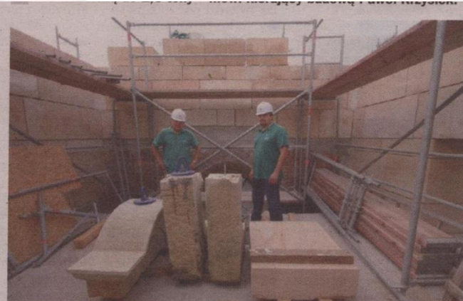
- W odbudowie wykorzystywane są także dobrze zachowane elementy ze zburzonej wieży - wyjaśnia Włodzimierz Żmuda, kierownik robót konserwatorskich.
