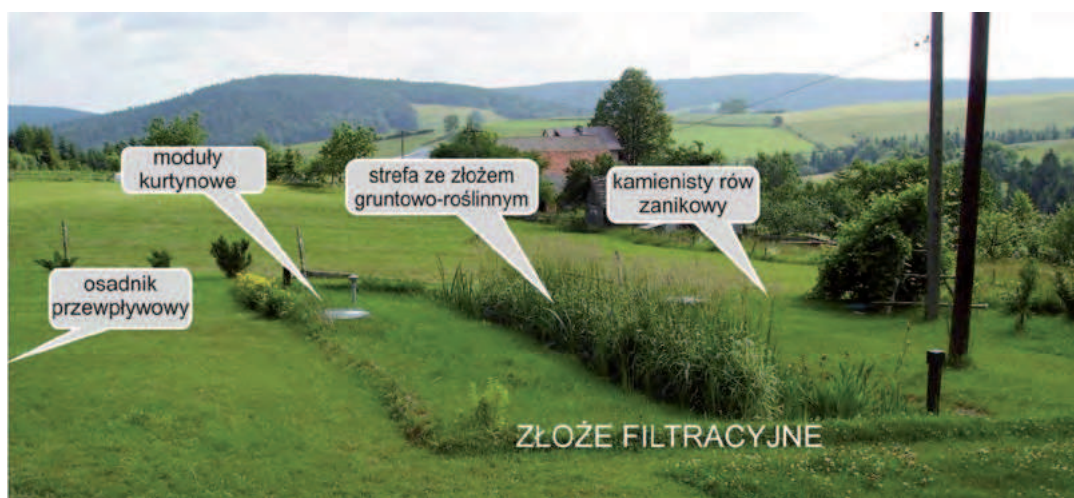
Fot. 7. Oczyszczalnia z zintegrowanym złożem filtracyjnym w gospodarstwie domowym zamieszkałym przez 5 osób
