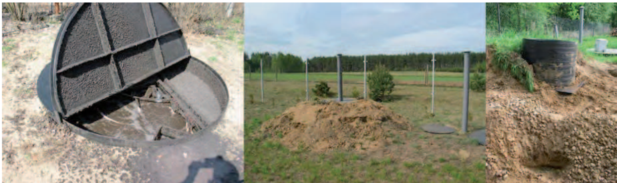
Fot. 10. Przykład oczyszczalni przydomowej z zastosowaniem metody osadu czynnego-rozwiązanie problematyczne dla indywidualnego użytkownika (zdjęcie: Wojciech Dąbrowski)
