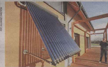
► Na południowej ścianie budynku znajduje się solar próżniowy oraz czepnie powietrza.
