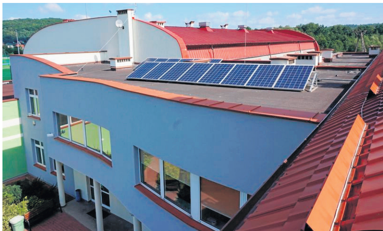
Instalacja fotowoltaiczna na dachu Zespołu Szkół Ponadpodstawowych w Nowinach poprawiła efektywność ogrzewania budynku.
