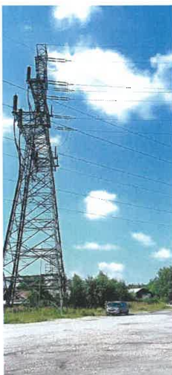
Słup kablowy nr 1
