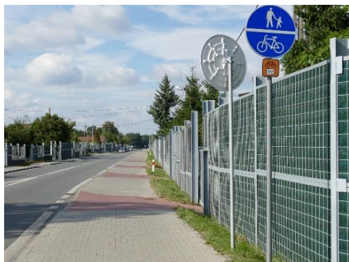
Rysunek 8. CPR wzdłuż DW Sielpia – Końskie nawierzchnia z kostki brukowej i brak zachowania niwelety na wyjazdach z posesji
