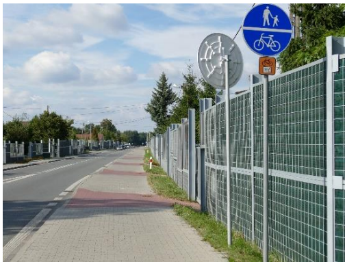
Rysunek 8. CPR wzdłuż DW Sielpia – Końskie nawierzchnia z kostki brukowej i brak zachowania niwelety na wyjazdach z posesji
