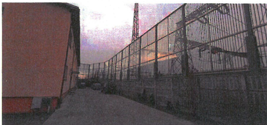
Stacja elektroenergetyczna 220/110 kV SE Radkowice. Ogrodzenie od strony budynku mieszkalnego
