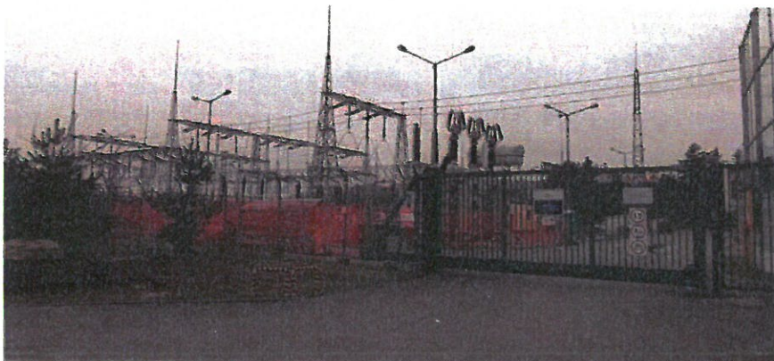
Stacja elektroenergetyczna 220/110 kV SE Radkowice. Brama wjazdowa
